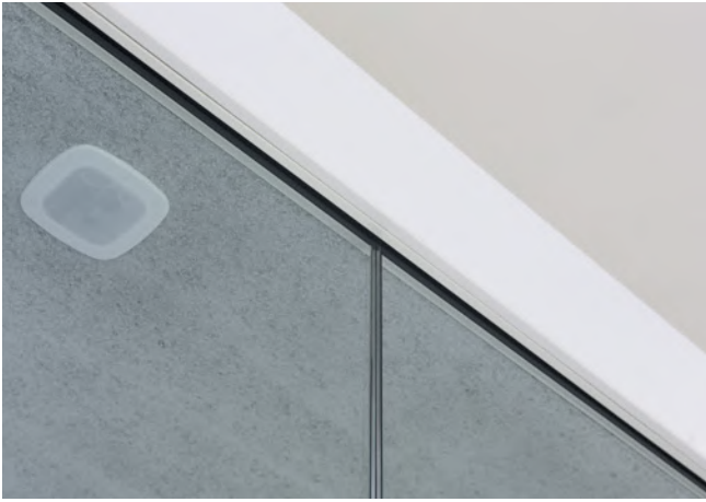
Eclairage LED au plafond avec détecteur de présence Ceiling-mounted LED lighting with presence sensor Ledverlichting in het plafond met bewegingssensor
